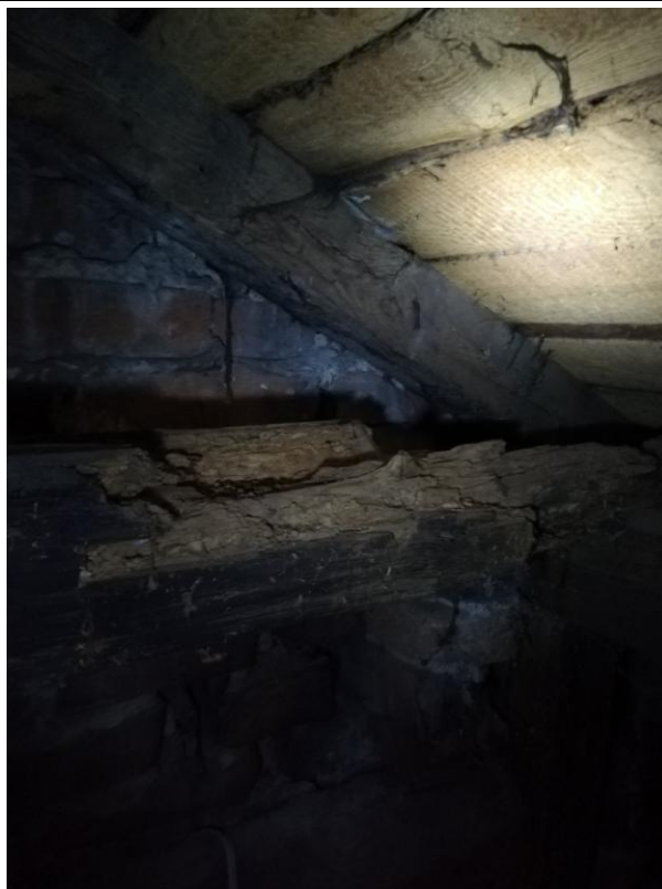
Rysunek nr 23 Widok na stan techniczny więźby dachowej (poddasze nieużytkowe nad salą zabaw i sceną)
