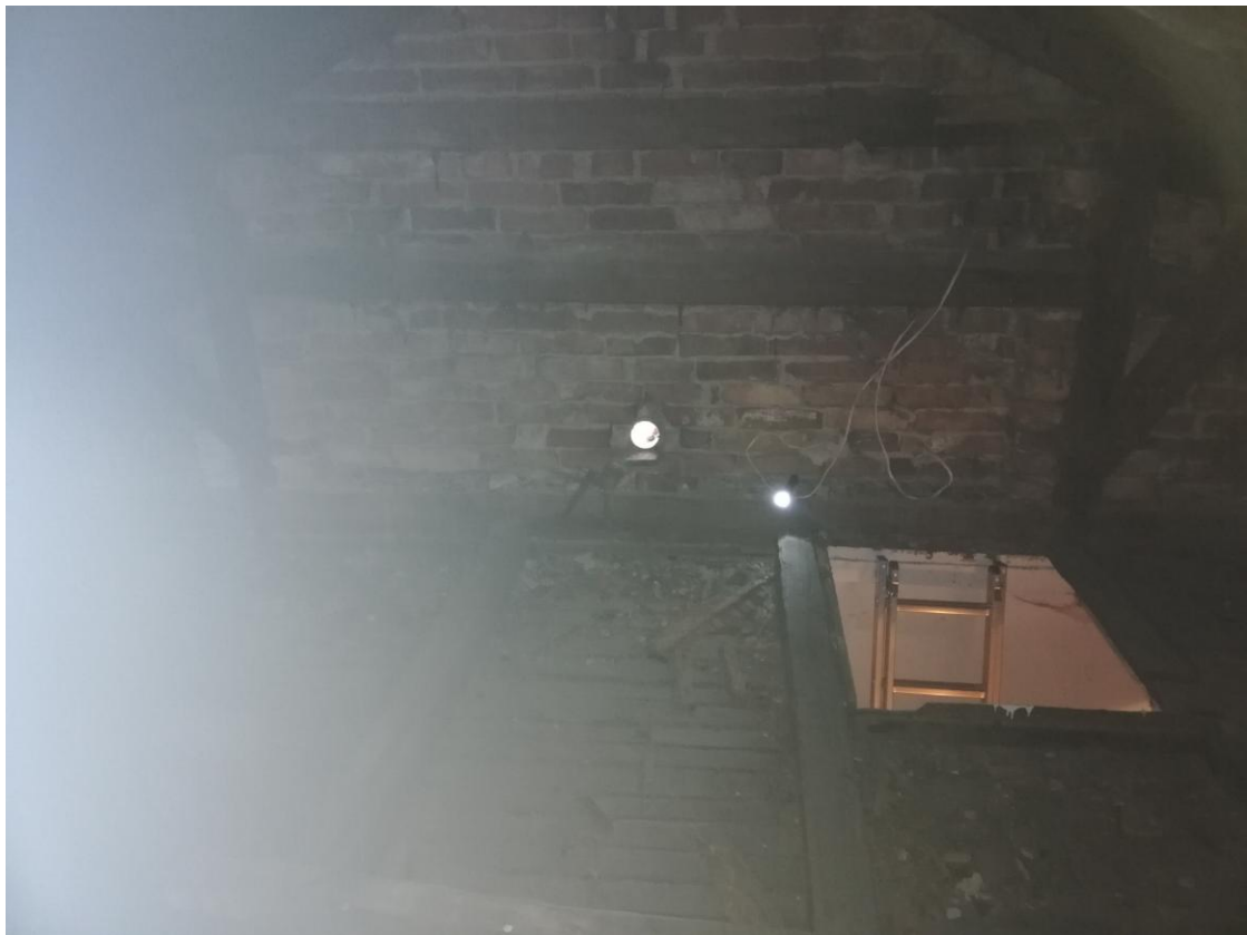
Rysunek nr 22 Widok na wylaz stropowy i wentylację (poddasze nieużytkowe nad salą zabaw i sceną)
