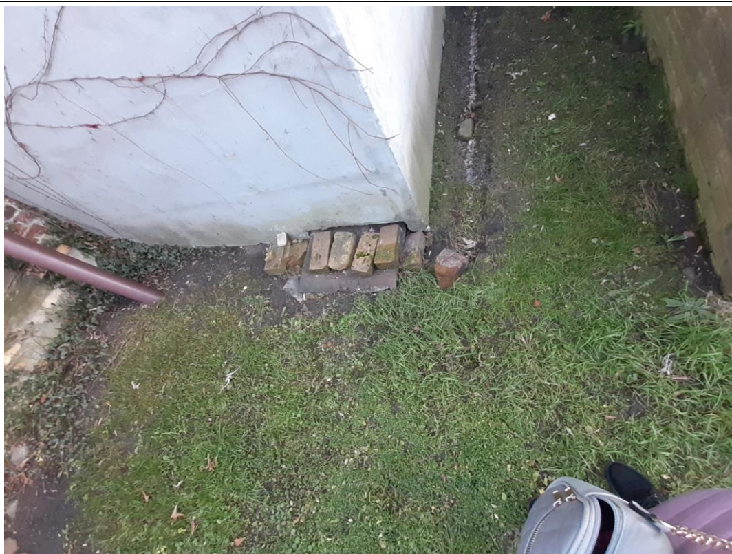
Rysunek nr 7 Widok na bezodpływowy zbiornik na nieczystości ciekłe znajdujący się pod budynkiem (częścią z pomieszczeniami sanitarnymi)
