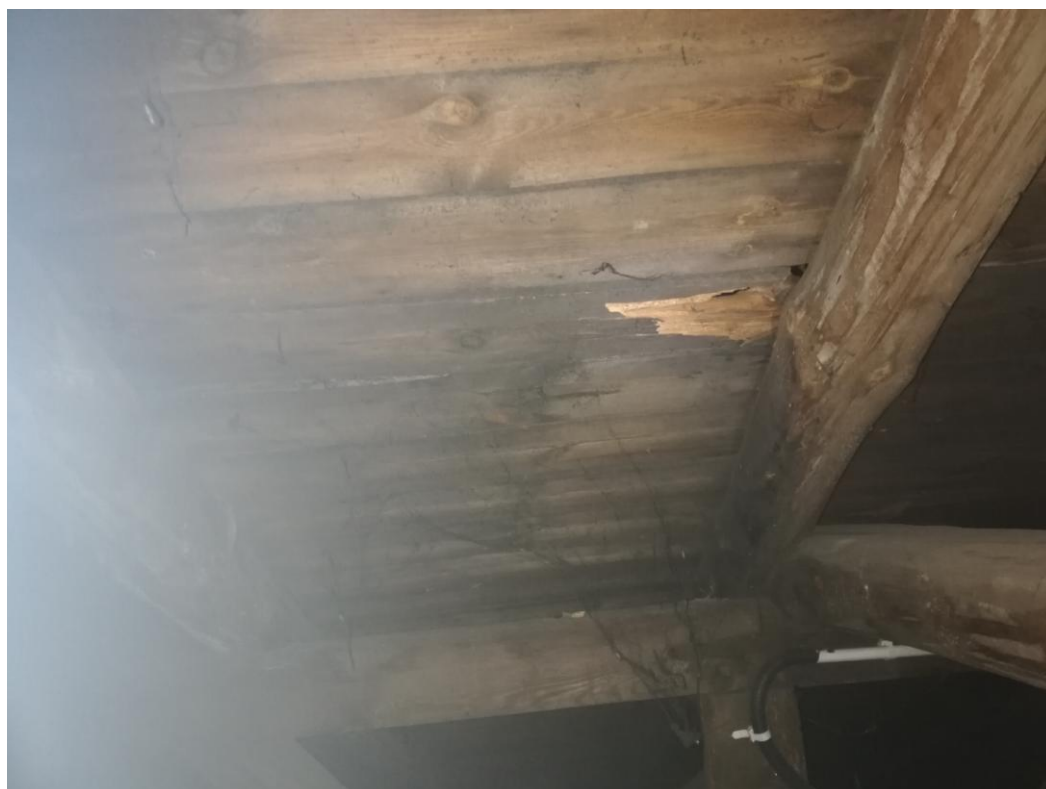
Rysunek nr 24 Widok na stan techniczny więźby dachowej (poddasze nieużytkowe nad salą zabaw i sceną)
