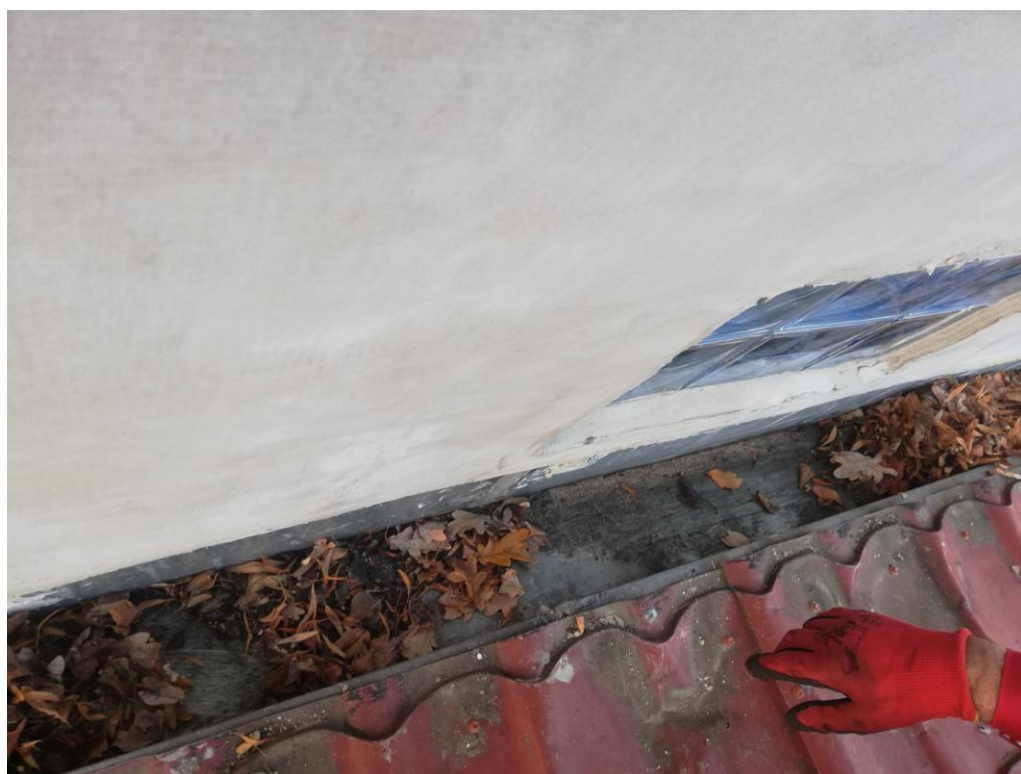
Rysunek nr 8 Stan koryta w miejscu styku z budynkiem sąsiednim (widoczne liczne zanieczyszczenia)
