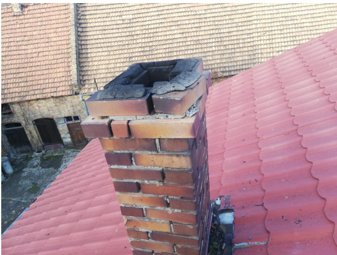
Rysunek nr 10 Stan techniczny komina (przewód dymowy)
