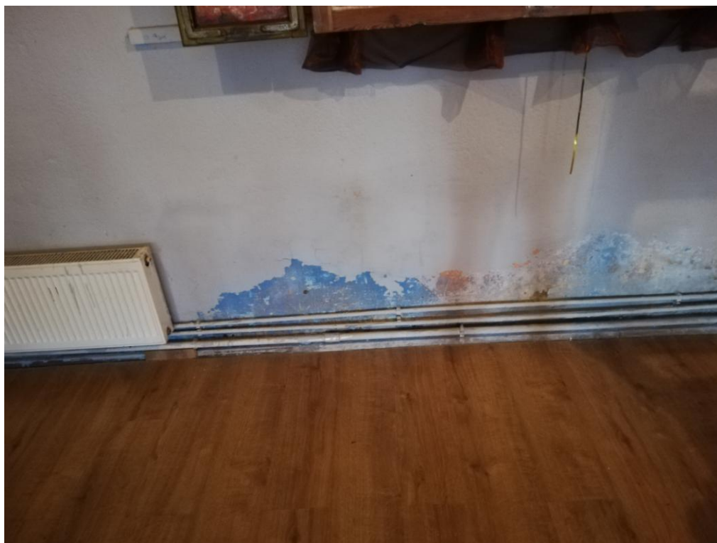
Rysunek nr 20 Widok stan powłok malarskich i instalacji c.o. (scena)
