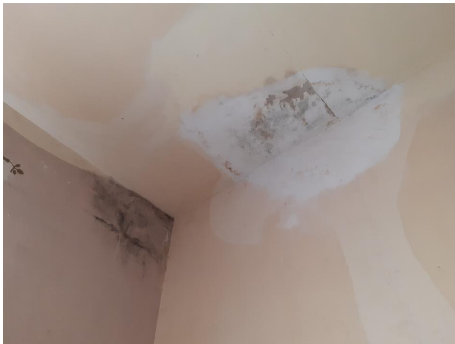
Rysunek nr 11 Widoczne liczne zacieki i zawilgocenia ścian wewnątrz budynku (pomieszczenie sali zabaw)
