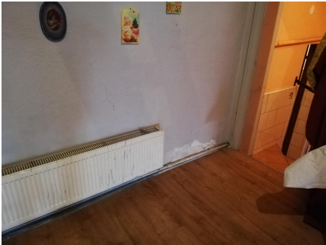
Rysunek nr 21 Widok stan powłok malarskich i instalacji c.o. (scena)
