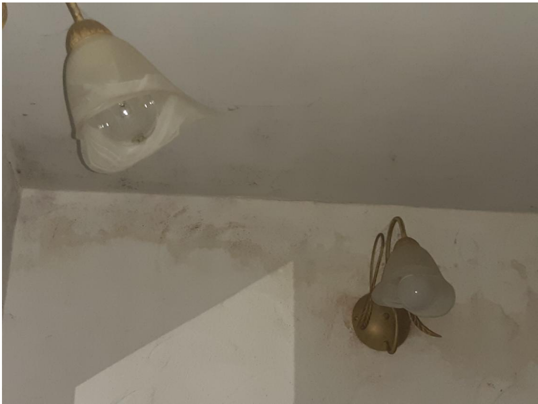
Rysunek nr 29 Oświetlenie oraz liczne zawilgocenia i zacieki na ścianach (pomieszczenie przedsiónek do WC)
