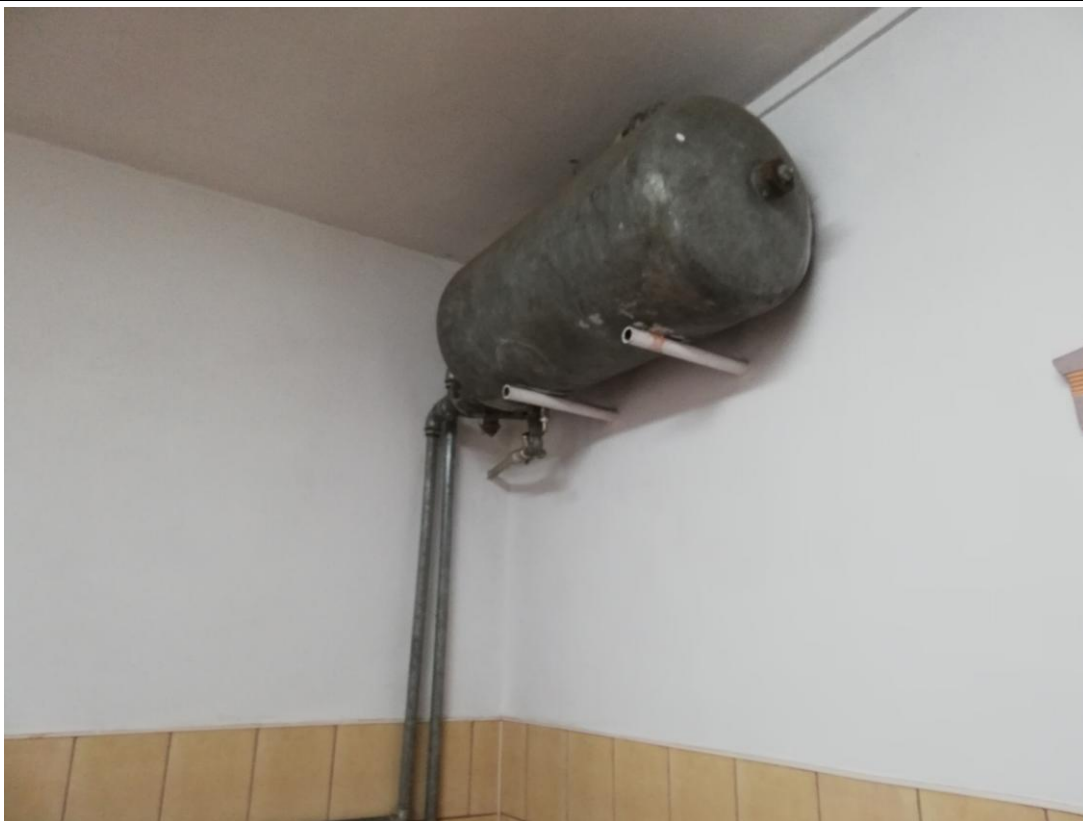
Rysunek nr 25 Widok na zbiornik c.w.u. (pomieszczenie kuchni)
