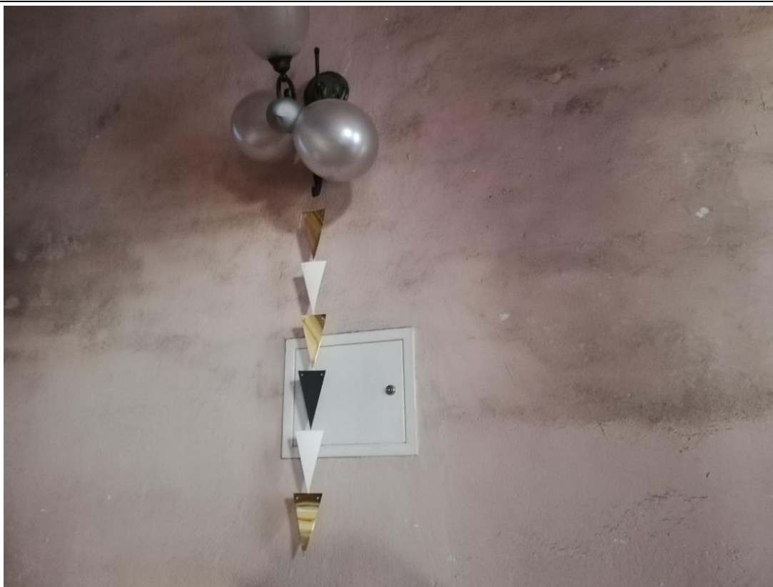
Rysunek nr 27 Stan techniczny ścian wewnątrz budynku (pomieszczenie sali zabaw)
